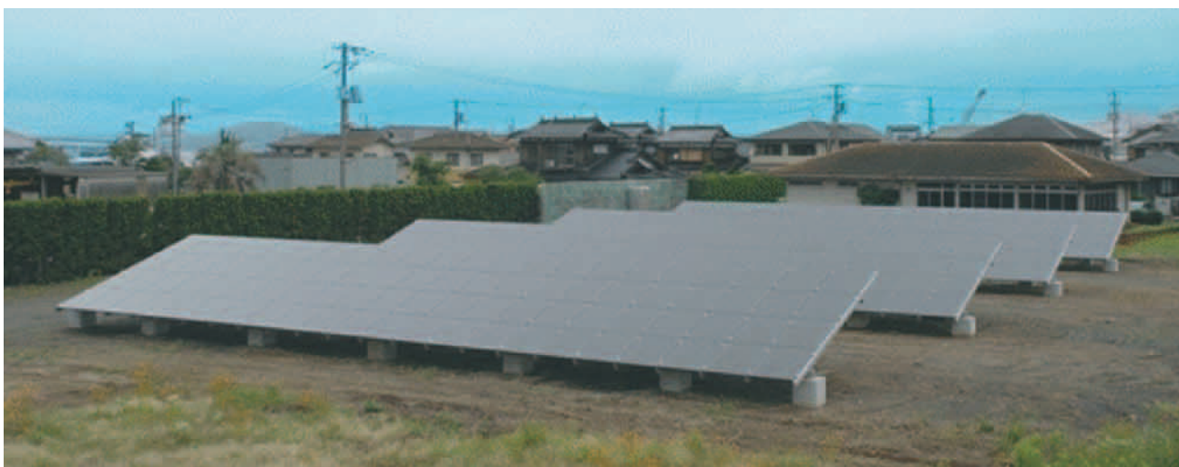
(図2)「小規模発電所パック」の設置例(山口県山陽小野田市)
